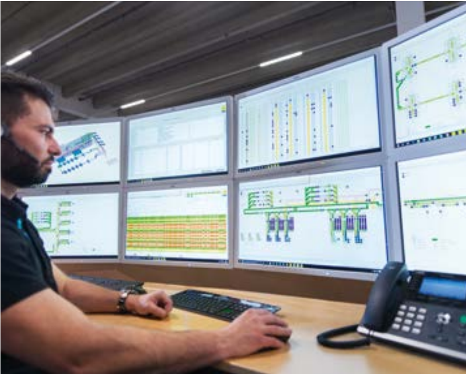
← Poste de contrôle avec psb selektron WMS et selektron SCADA pour le contrôle et la surveillance du système intralogistique
